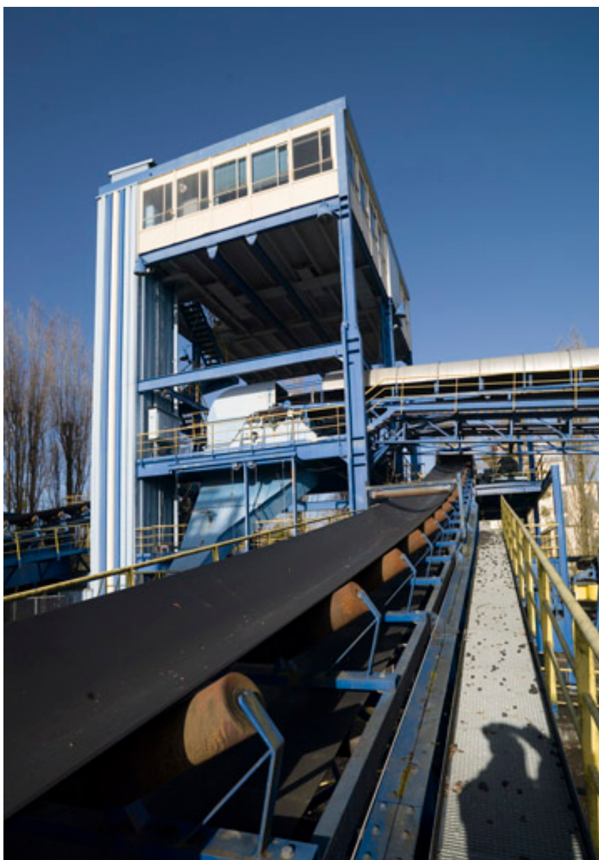
Parc a charbon. Manutention. Tapis-jeteur.
