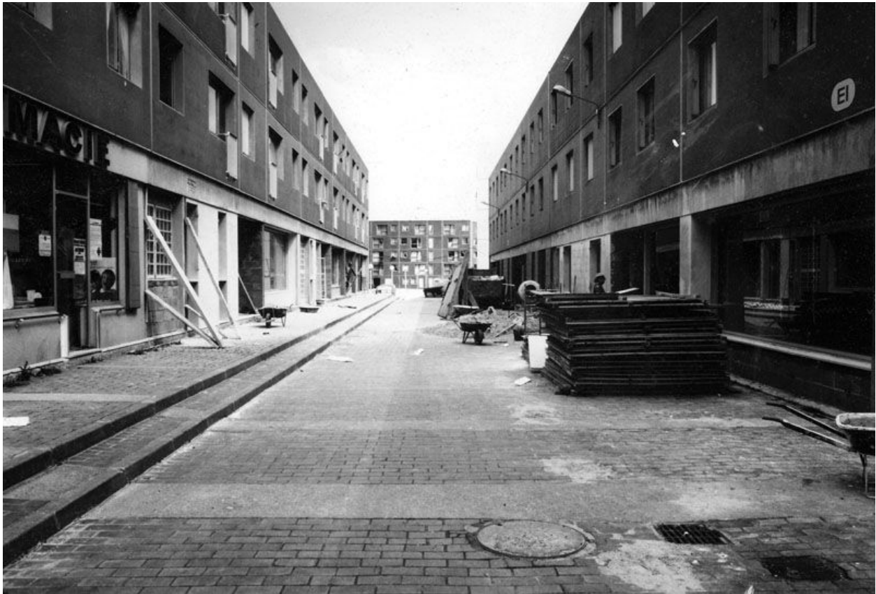
La Noé. Passage entre la place du Béguinage et la place des Arcades. De part et d'autres les RDC accueillent des locaux commerciaux encore en chantier. Photographie, 1976. Photographie, 1976. (Mairie de Chanteloup-les-Vignes).
