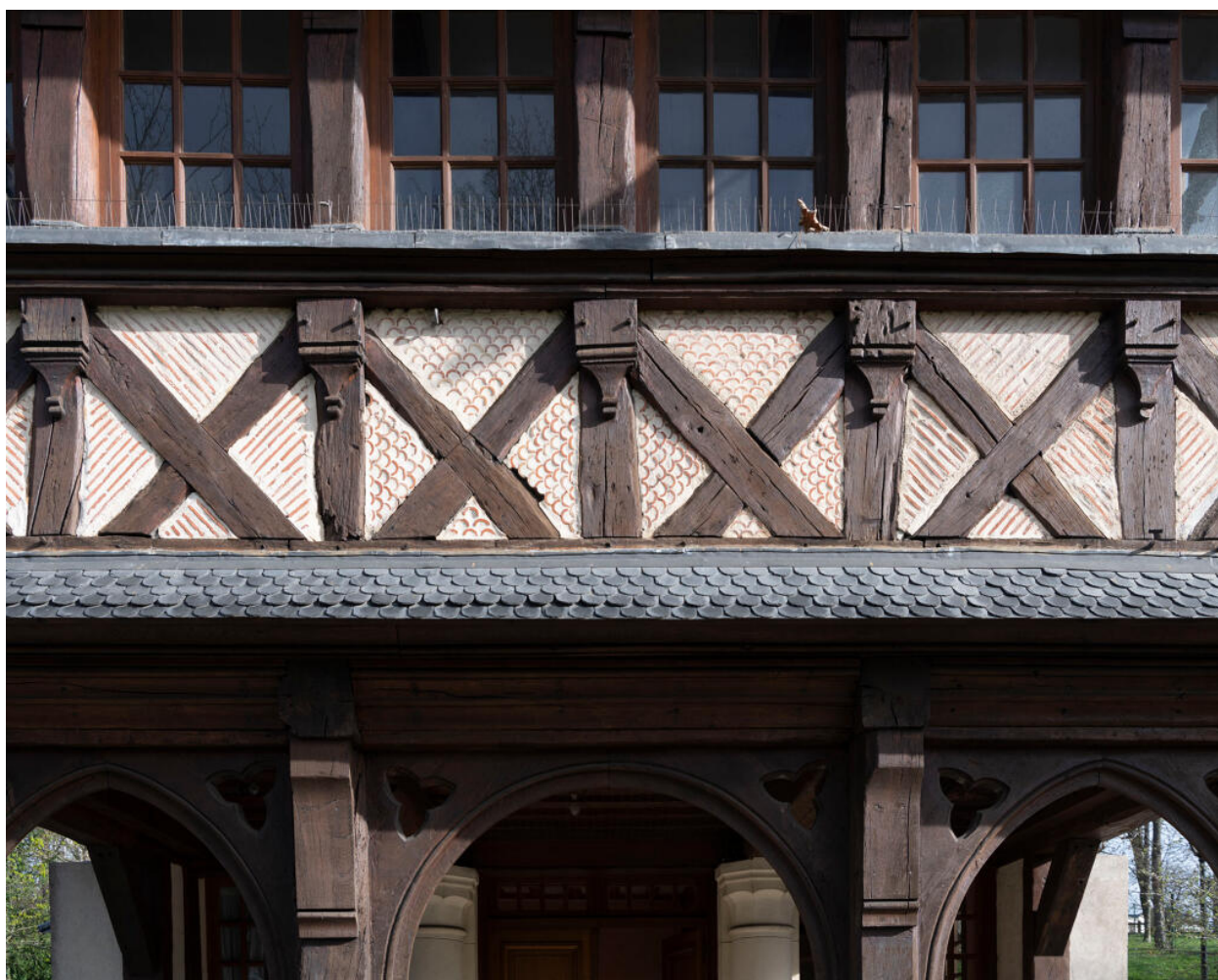
Façade sud, détail du porche rapporté, surmonté de croix de Saint André.
