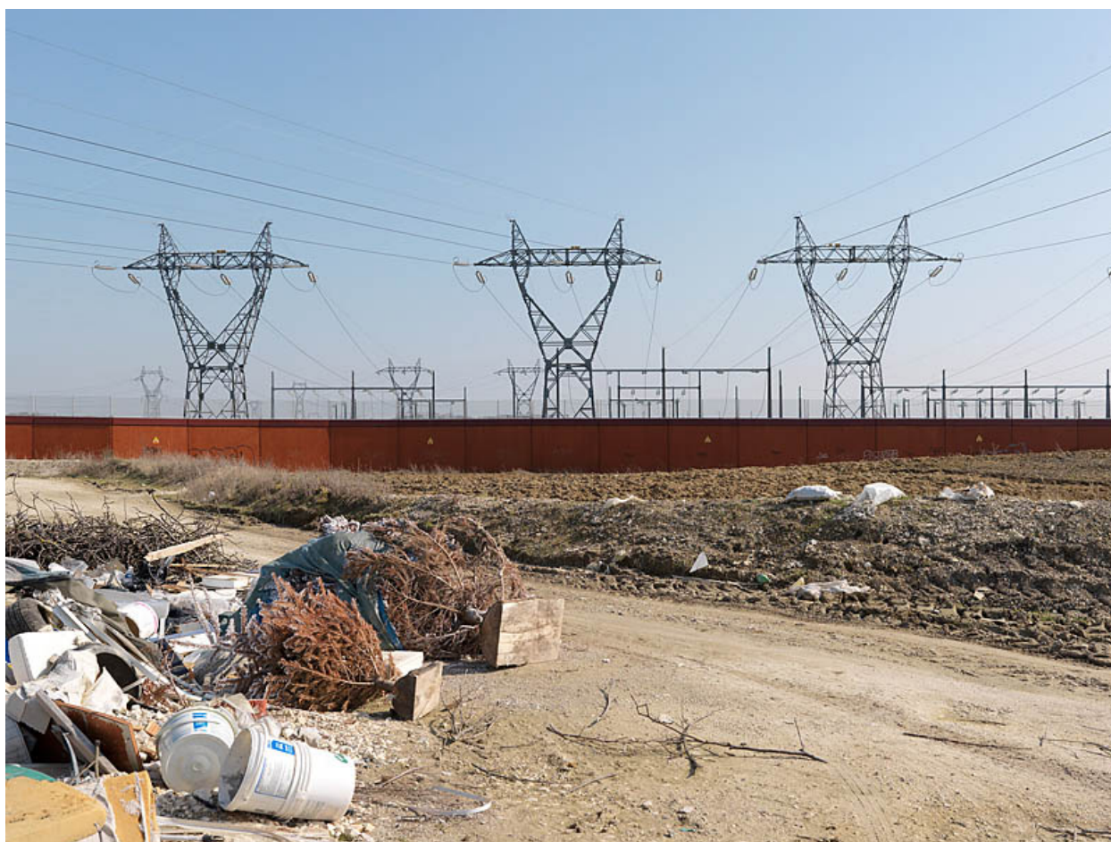
93, Tremblay-en-France. Poste électrique.
