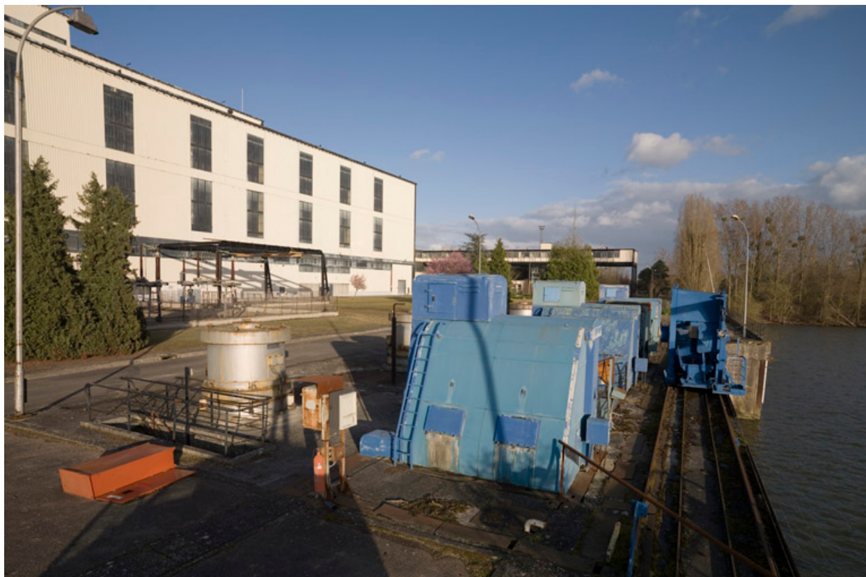
Stations de pompage.
