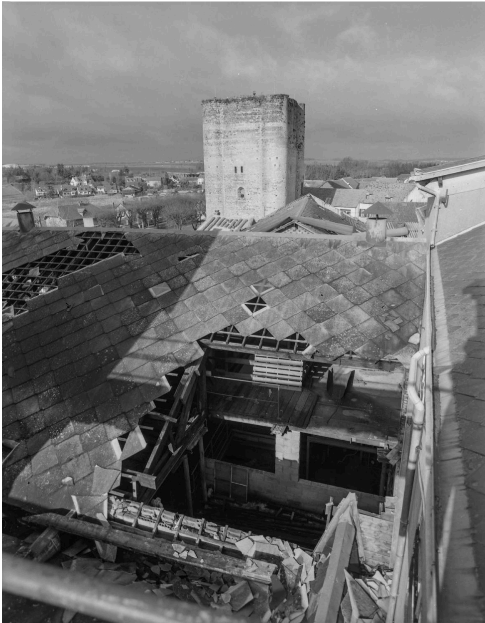
Vue de la toiture du bâtiment B. Détail des dommages de la tempête de décembre 1999. Au second plan le donjon.
