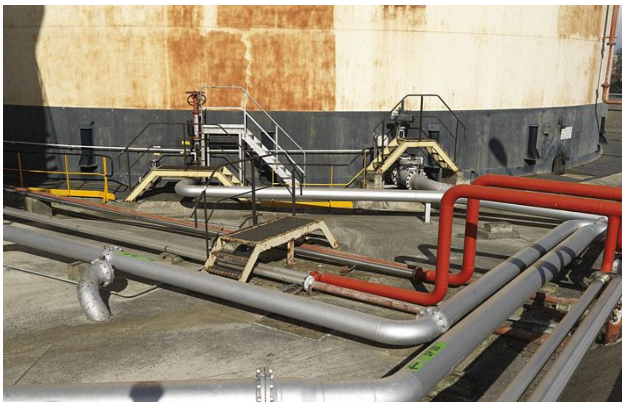
Villeneuve-le-Roi, dépôt pétrolier. Détail des canalisations d'alimentation.
