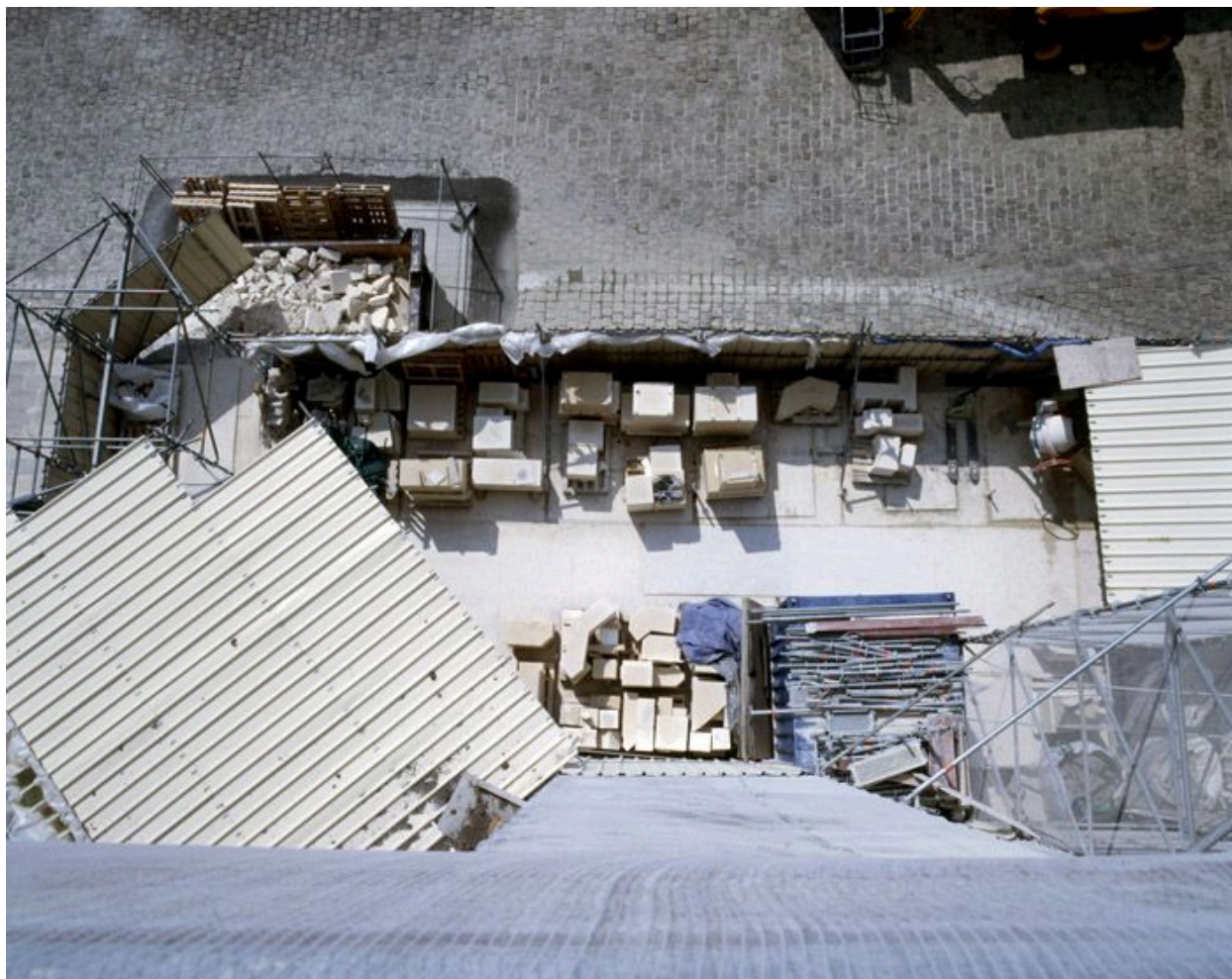
La façade occidentale : vue du chantier de restauration de la base de la tour nord (2008).
