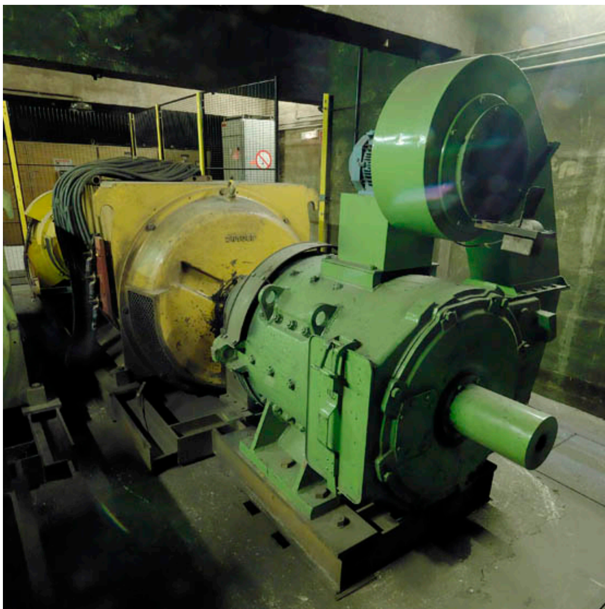
Plateforme d'essais. Entreprise Jeumont-Electric.
