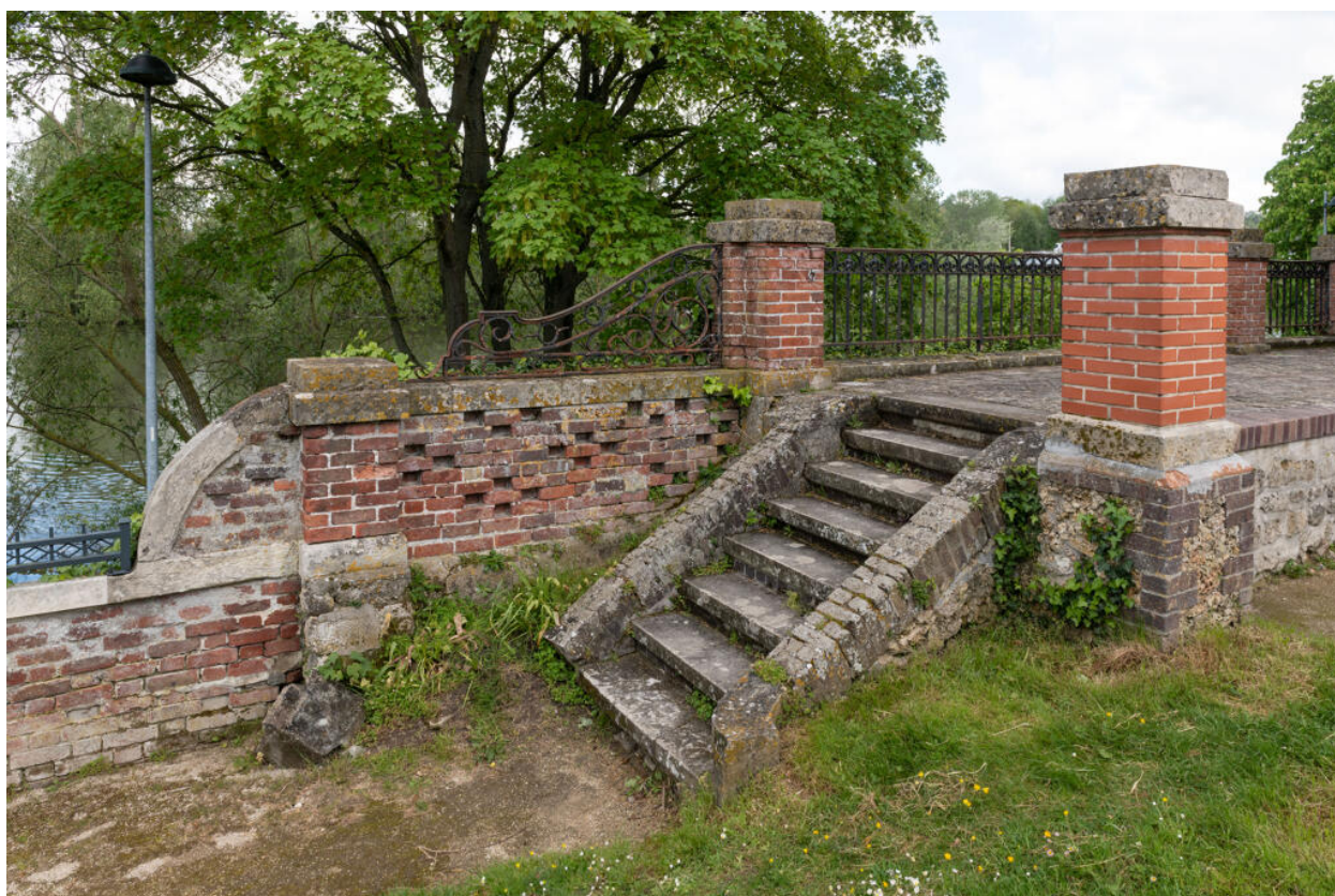
Détail de l'escalier d'accès à la terrasse et de son garde-corps en fer forgé.
