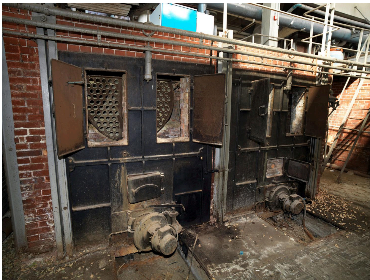
Détail des chaudières à charbon.
