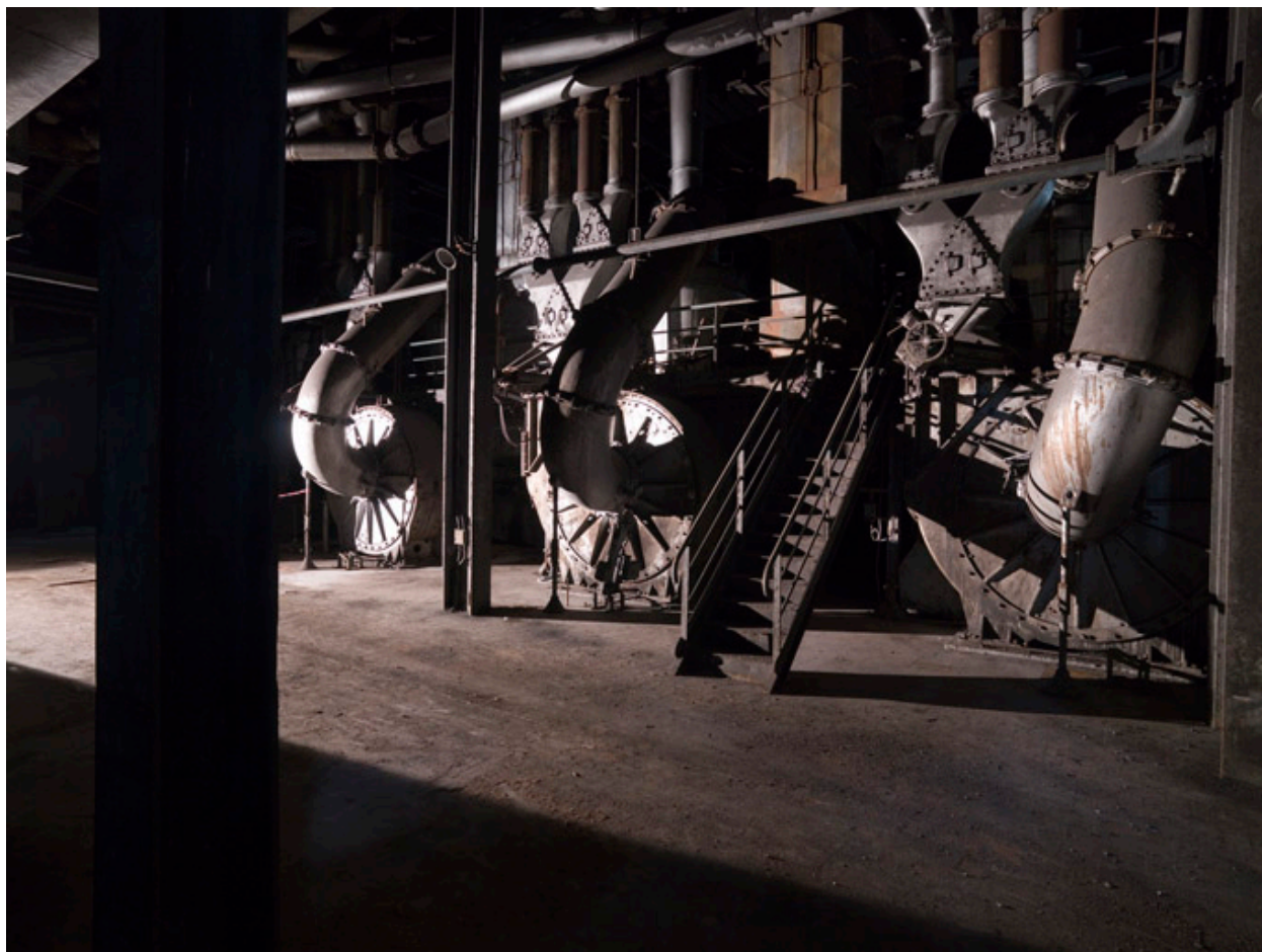
Générateur de vapeur groupe 125MW. Broyeur.
