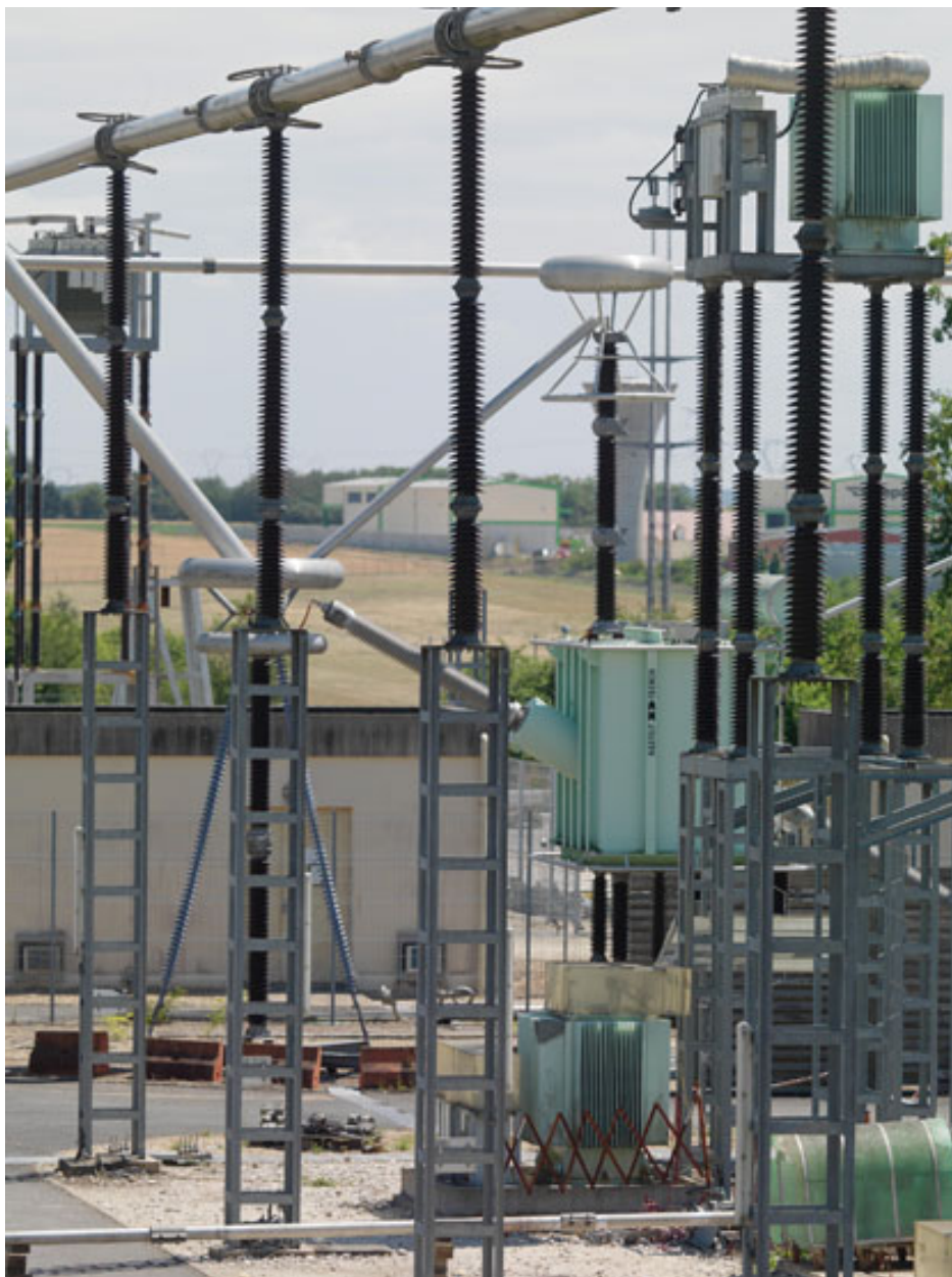
Installations électriques expérimentales.
