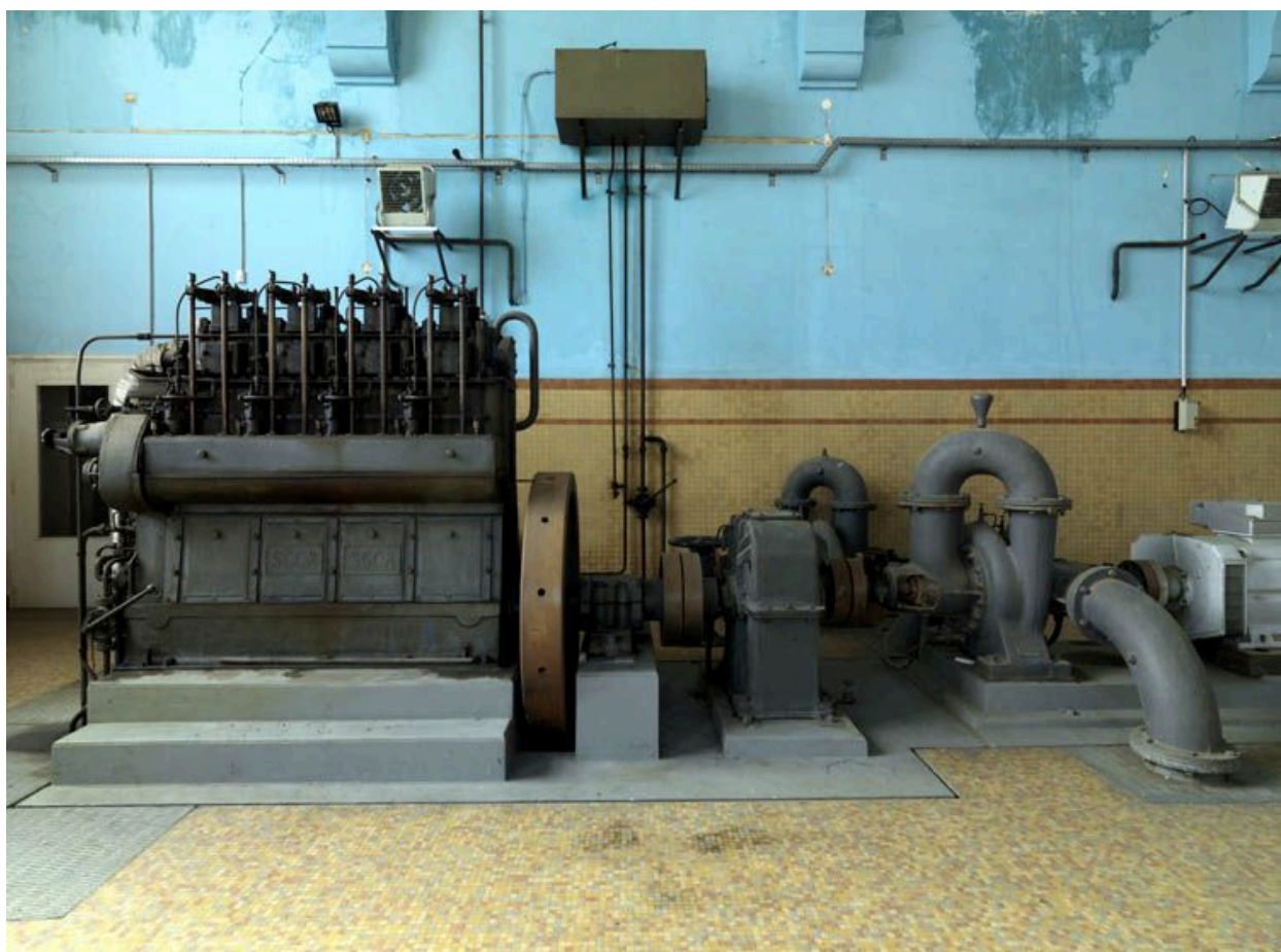
Groupe ancien avec moteur diesel type Man et moteur électrique.
