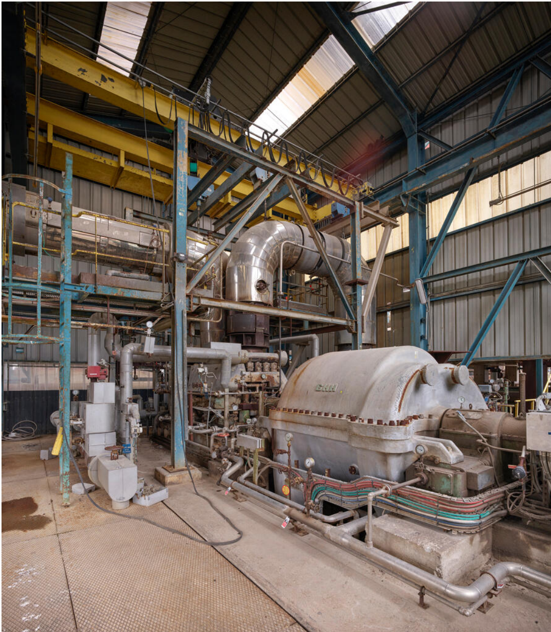
Unités Est - Zone FCC (Unité 651). Compresseur turbo-alternateur, autrement dit compresseur à récupération d'énergie.
