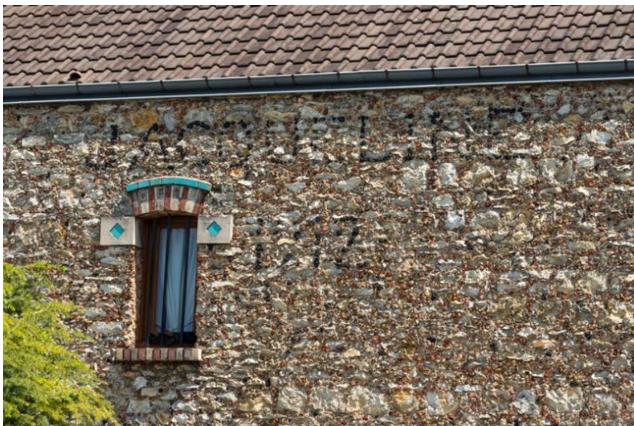
Les Mureaux. Maisons jumelles, 32-34, boulevard du Maréchal Foch. Détail de rocaillage du mur latéral.
