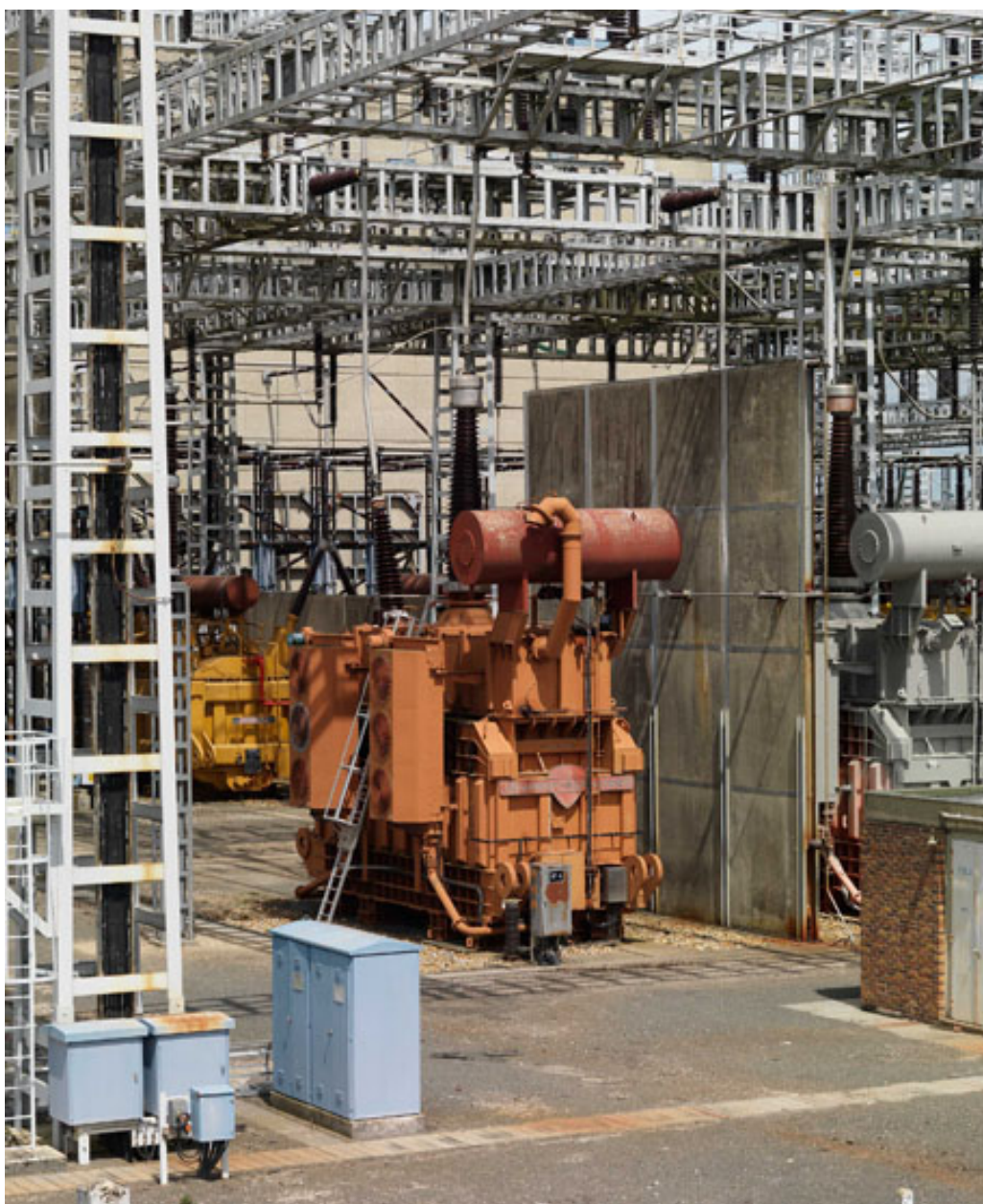
Charpente électrique extérieure.
