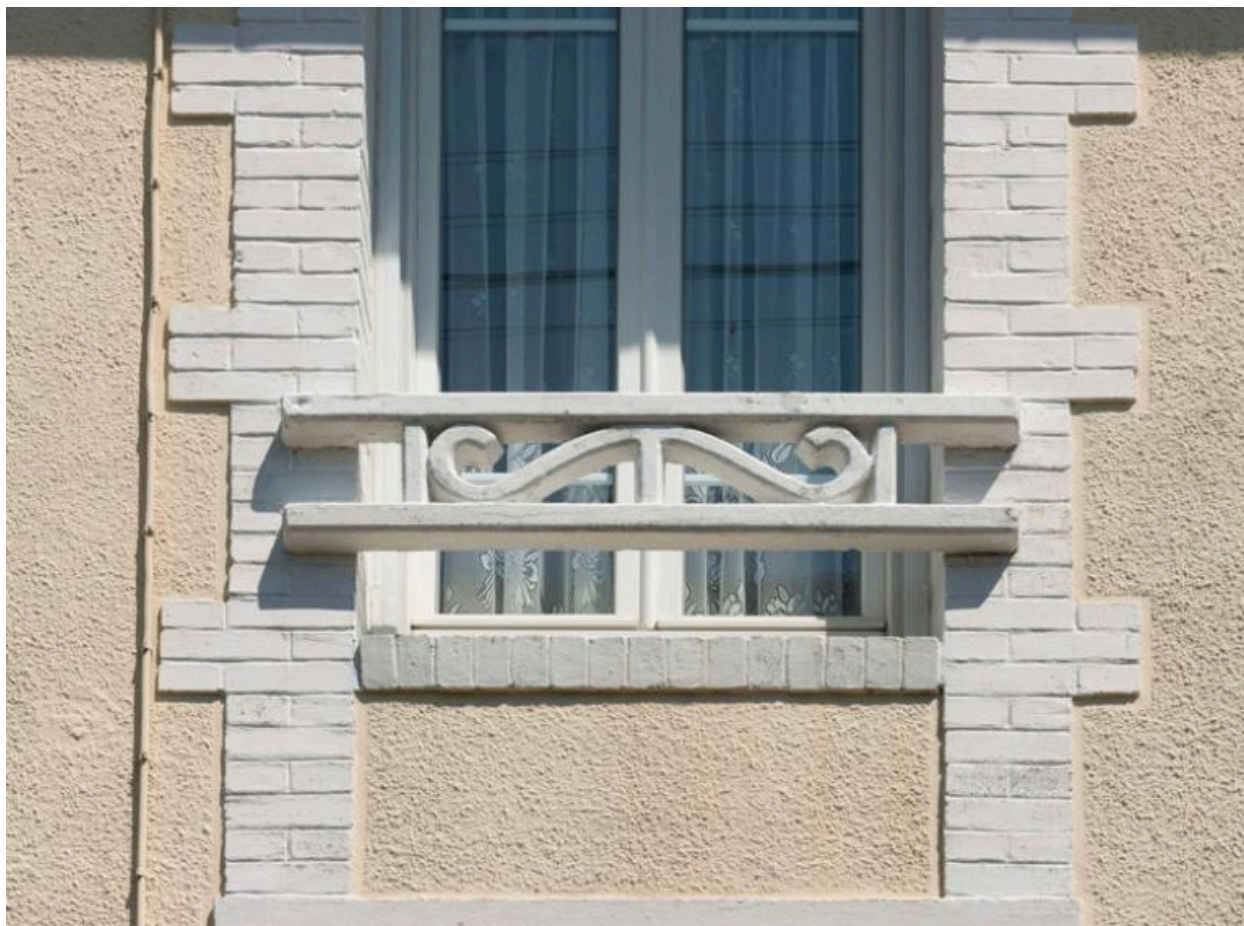
Les Mureaux. Logements ouvriers, rue du Pont-de-Claix. Détail d'un garde-corps en ciment.
