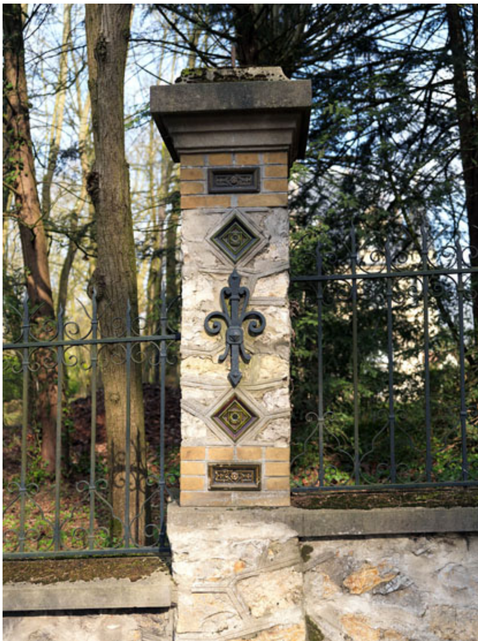
Détail du mur de clôture de la villa : pilier à décor de grès cérame et fer d'ancrage.
