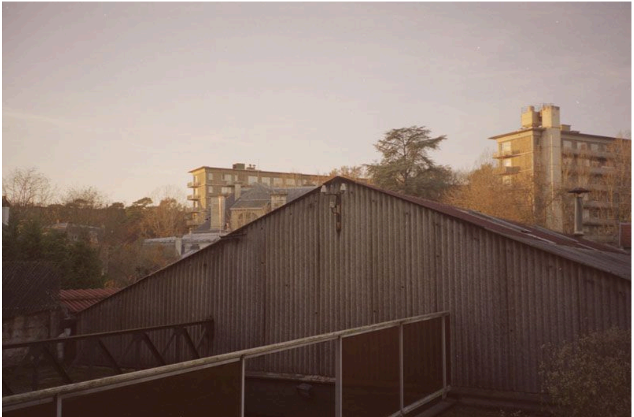
Pignon et toiture de l'atelier de transformation, depuis le toit terrasse des anciens bureaux. Photographie. (Collection particulière)
