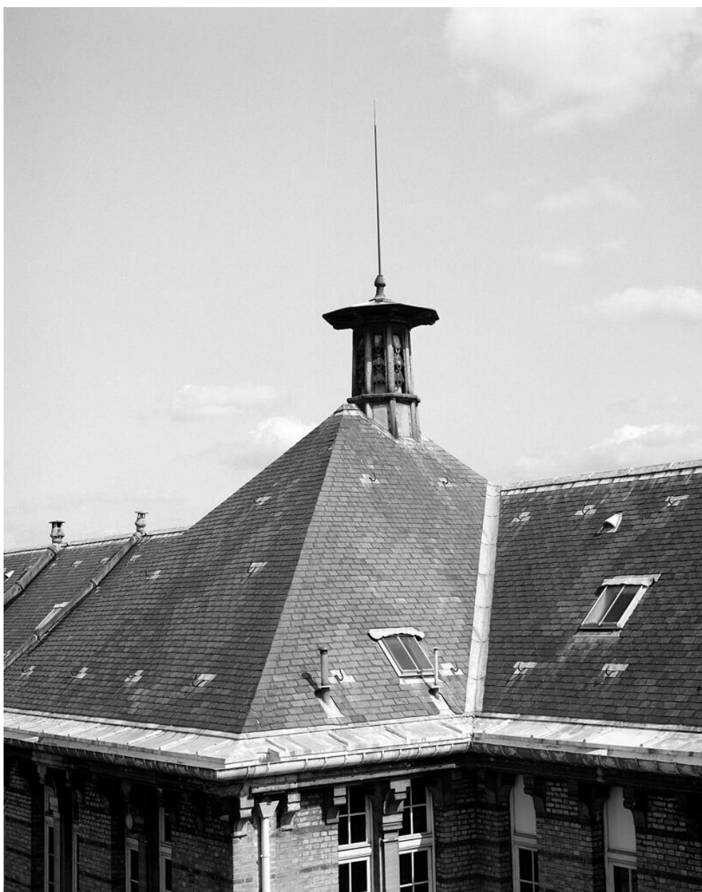
Cour des réfectoires : Lanterneau coiffant la toiture des avant-corps. Lycée dit Lycée Lakanal
