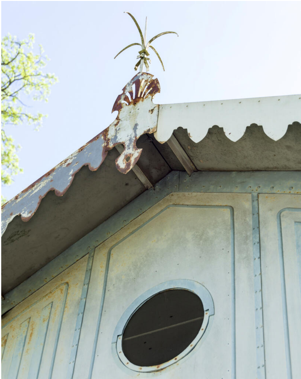
Détail de l'épi de faitage au droit du pignon postérieur à lambrequins.
