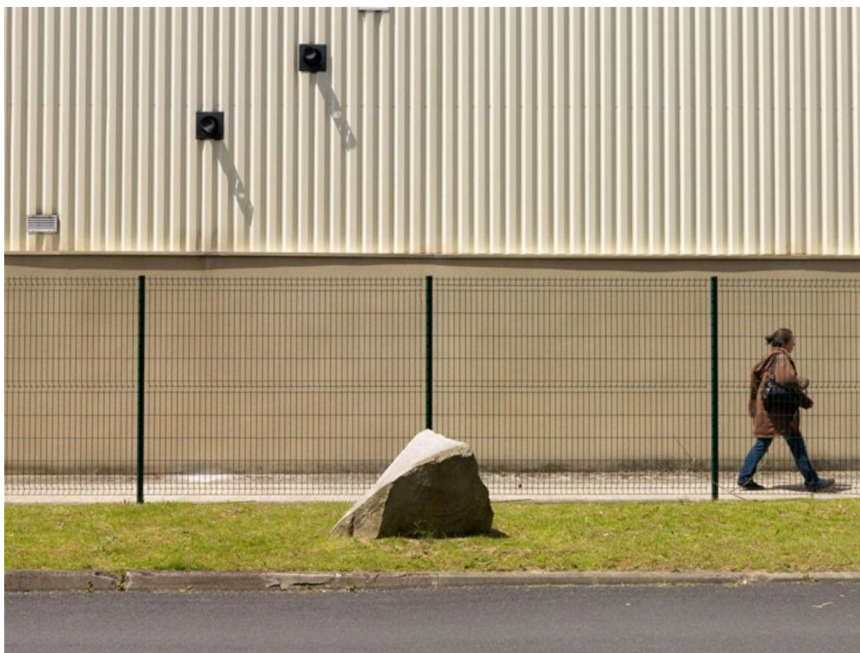
Les Ulis, avenue de l'Océanie. Détail de bardage d'un entrepôt de la zone d'activité.
