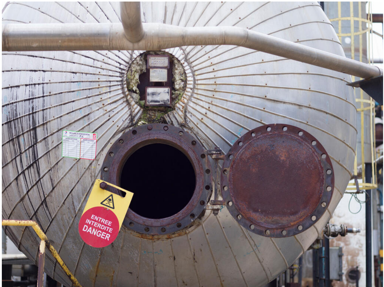
Unités Ouest - Zone de distillation (Unité 612). "Trou d'homme" (entrée) destiné à la maintenance du dessaleur.
