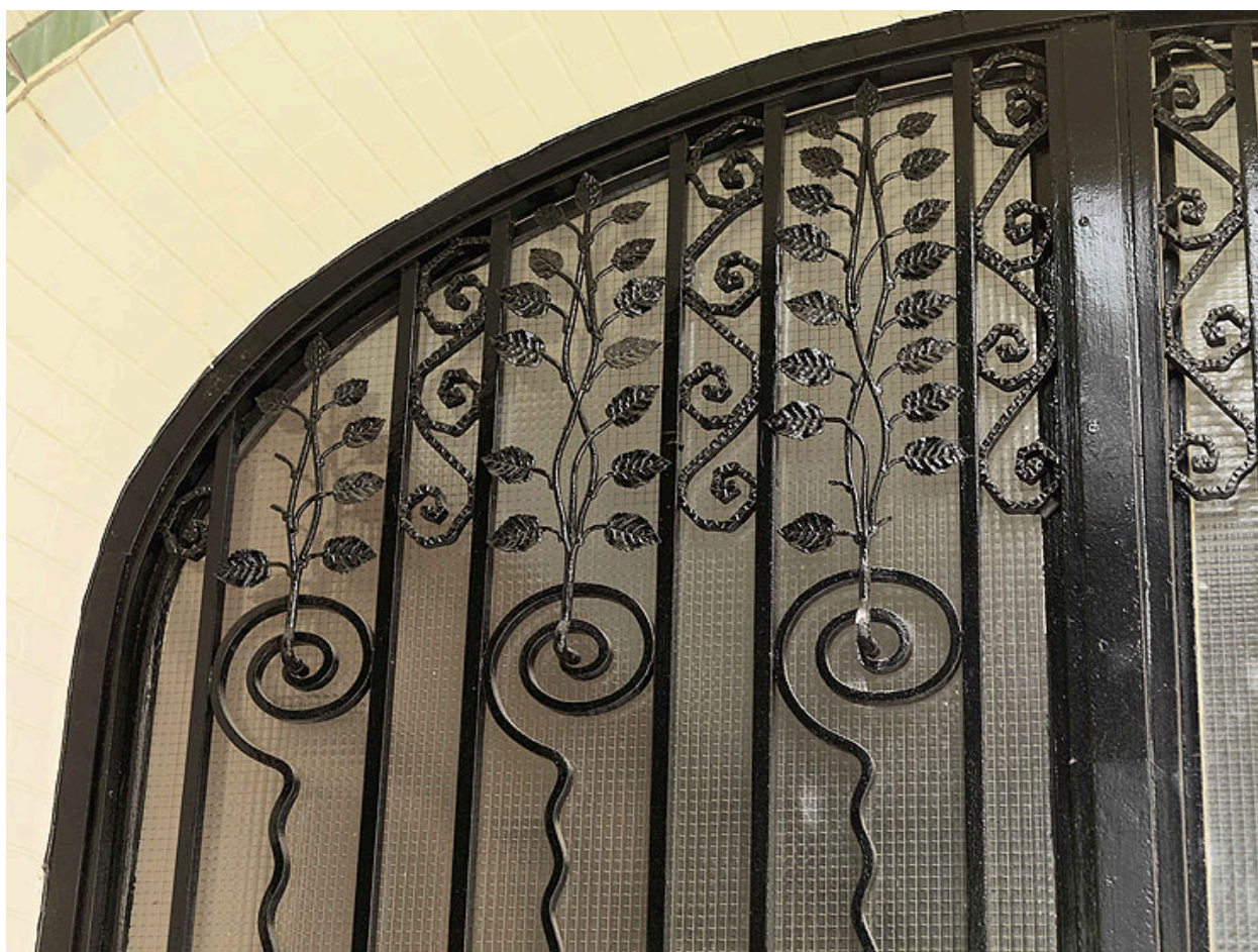
Détail de la porte d'entrée. Travail de ferronnerie d'art : détail des feuillages de la partie supérieure.
