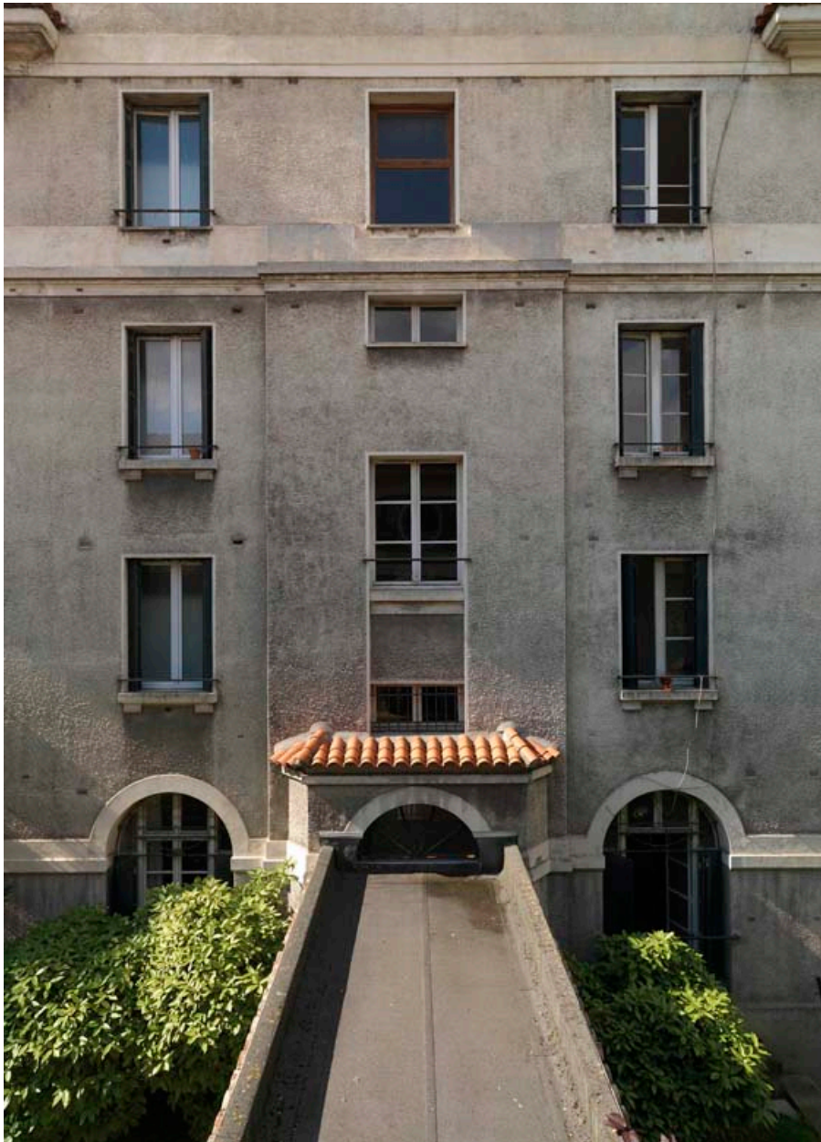
La galerie de liaison entre les deux bâtiments, vue d'en haut, depuis le petit pavillon.
