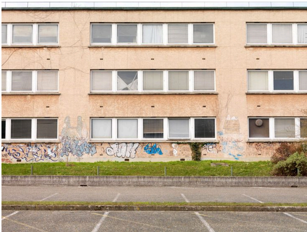
Bures-sur-Yvette, rue du Doyen-André Guinier. Université de Paris11-Orsay, vue d'un bâtiment d'enseignement et de recherche.
