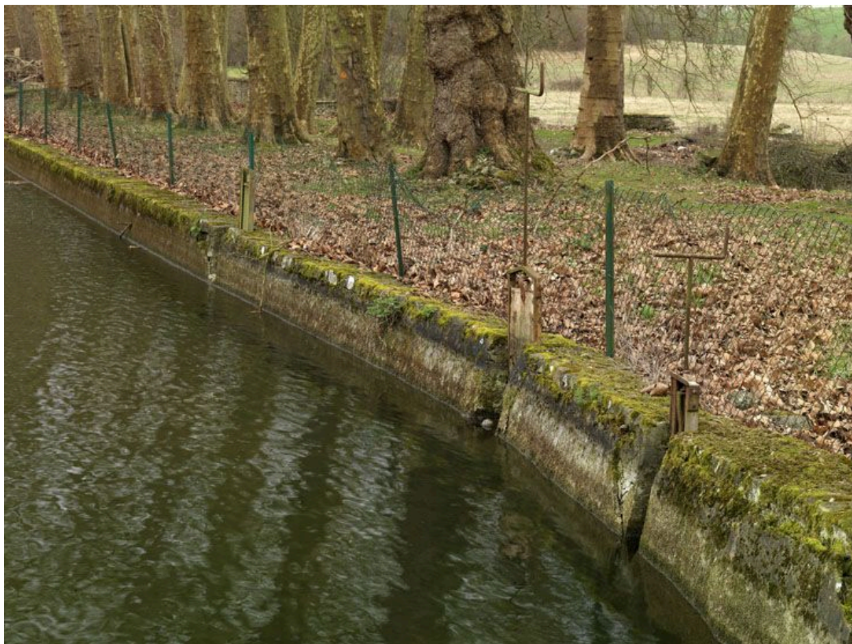
Bassin de retenue, détail de la vanne du déversoir.
