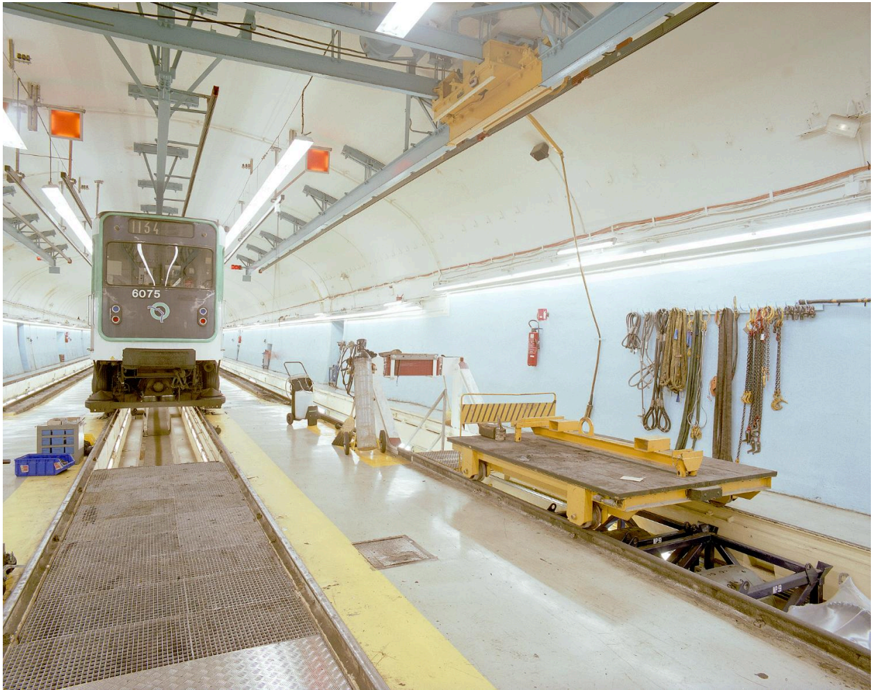
Fosses de maintenance. Train en attente.
