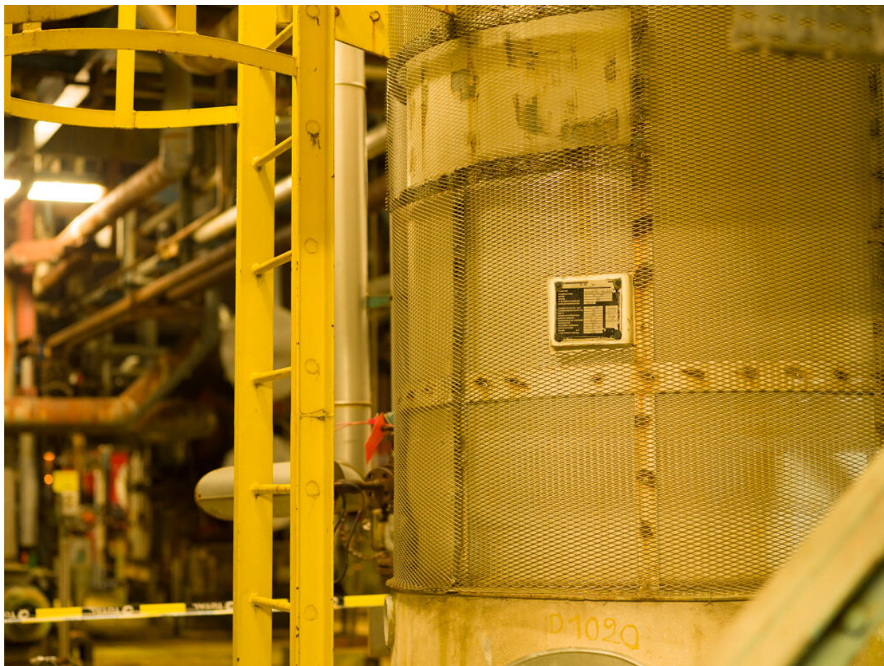
Unités Ouest - Hydrodésulfuration des gasoils "HDS" - HDS 2 (Unité 662). Ballon de refoulement 662 D1020 du compresseur.
