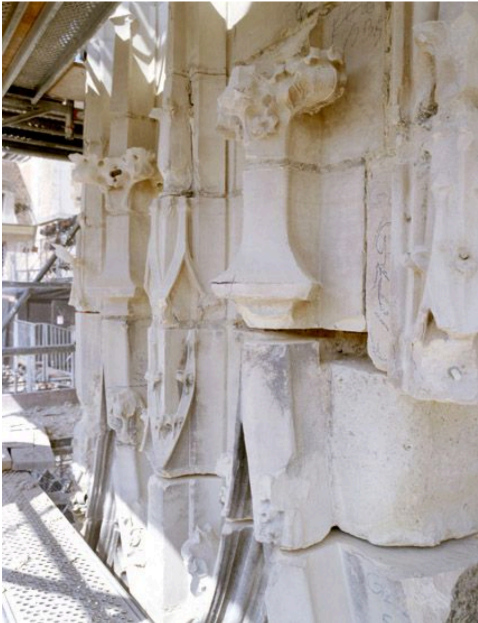
La façade occidentale : vue du chantier de restauration de la base de la tour nord (2008). Détail de la restauration des gâbles flamboyants.
