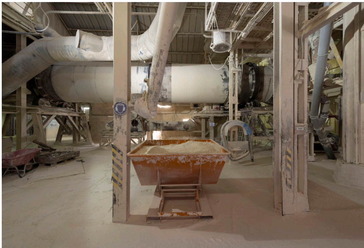
Usine de filler BR1. Séchage au gaz dans un cylindre rotatif VERNON (14x10m) avec filtre a manches.
