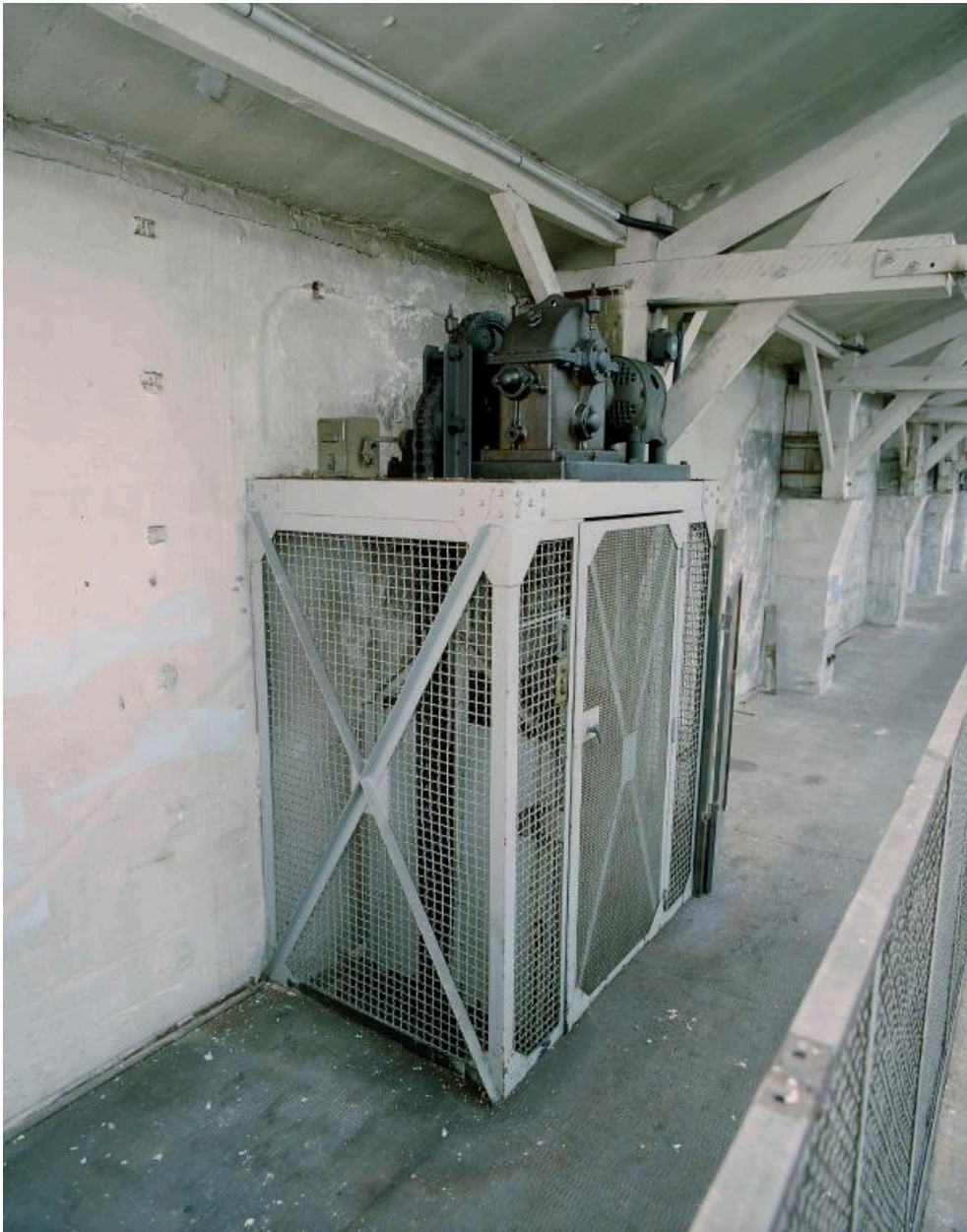
Monte-charge du magasin des pièces détachées.
