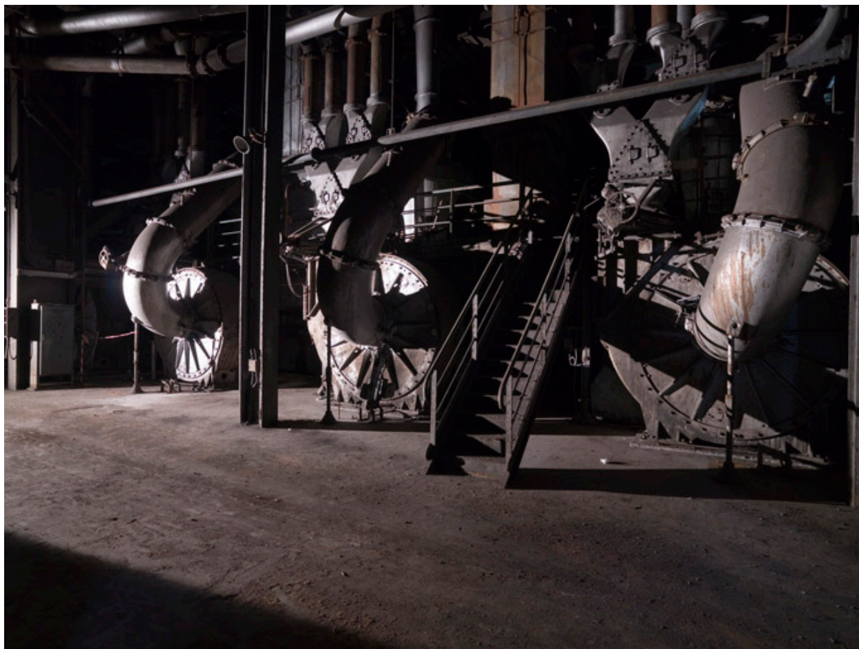
Générateur de vapeur groupe 125MW. Broyeur.
