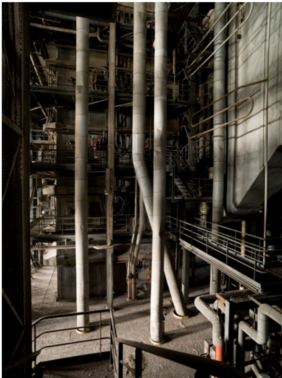
Générateur de vapeur 250 MW.
