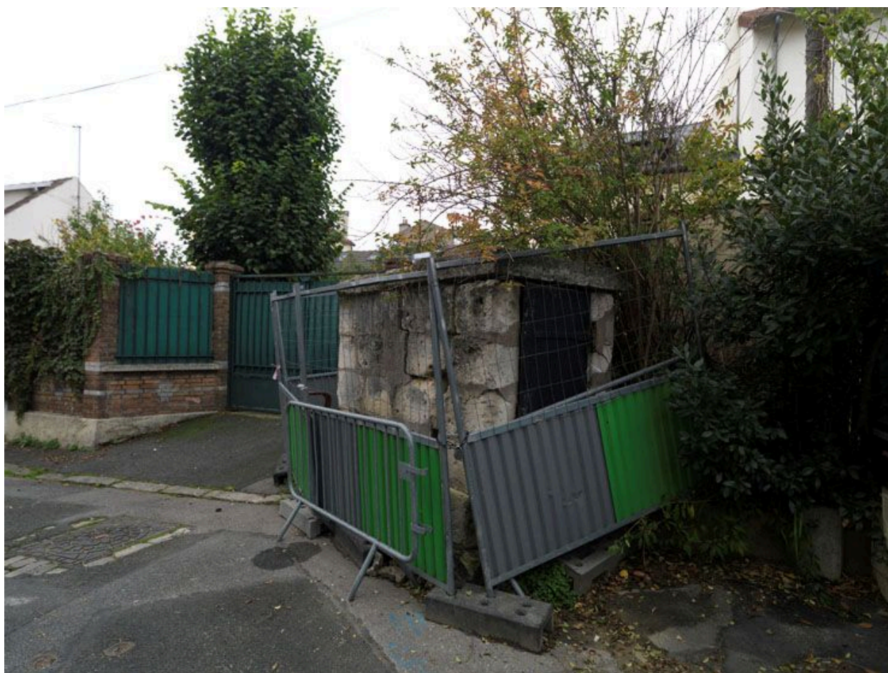
Arcueil, Gustave-Edouard (impasse). Vue sur le regard XVII endommagé.
