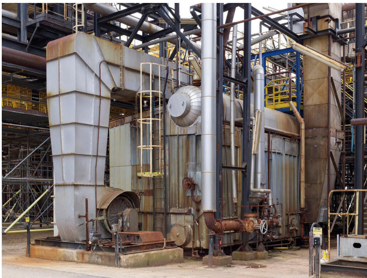
Unités Ouest. Unité 430, chaudière 430 F1 avec sa soufflante au premier plan.
