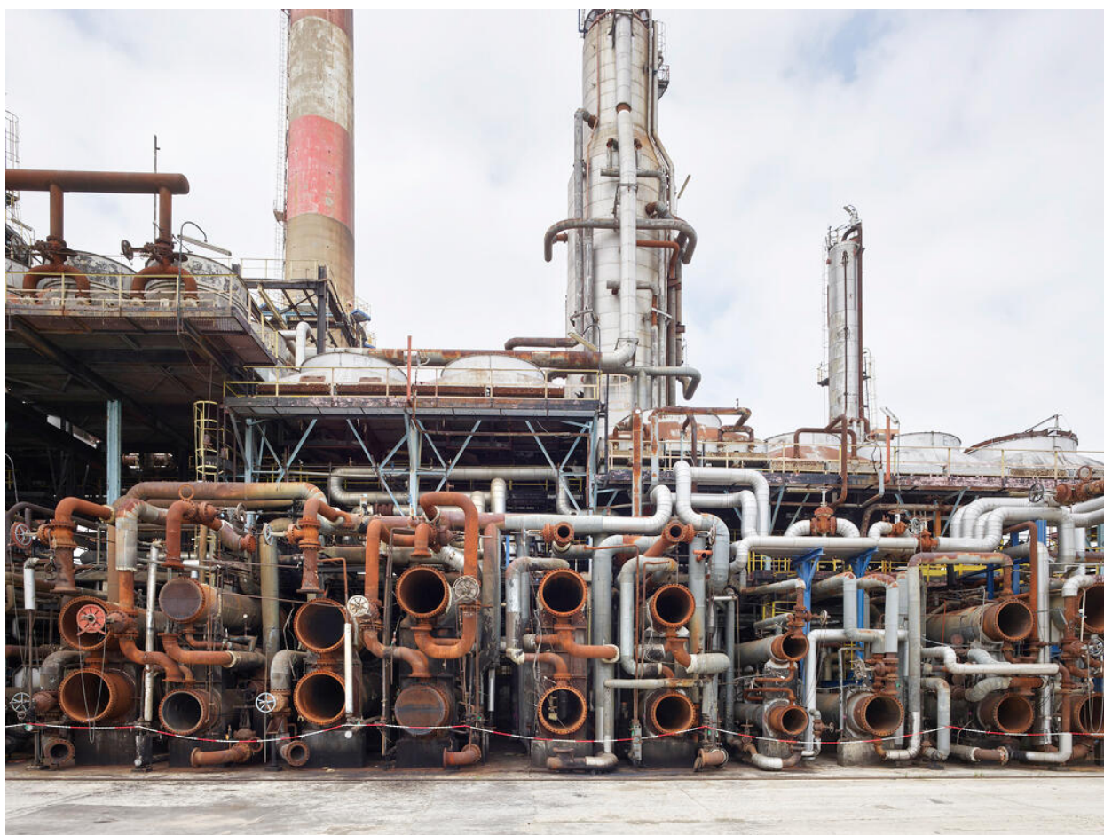
Unités Ouest. Vue d'ensemble des trains d'échange de l'unité 612 de distillation atmosphérique/sous-vide.
