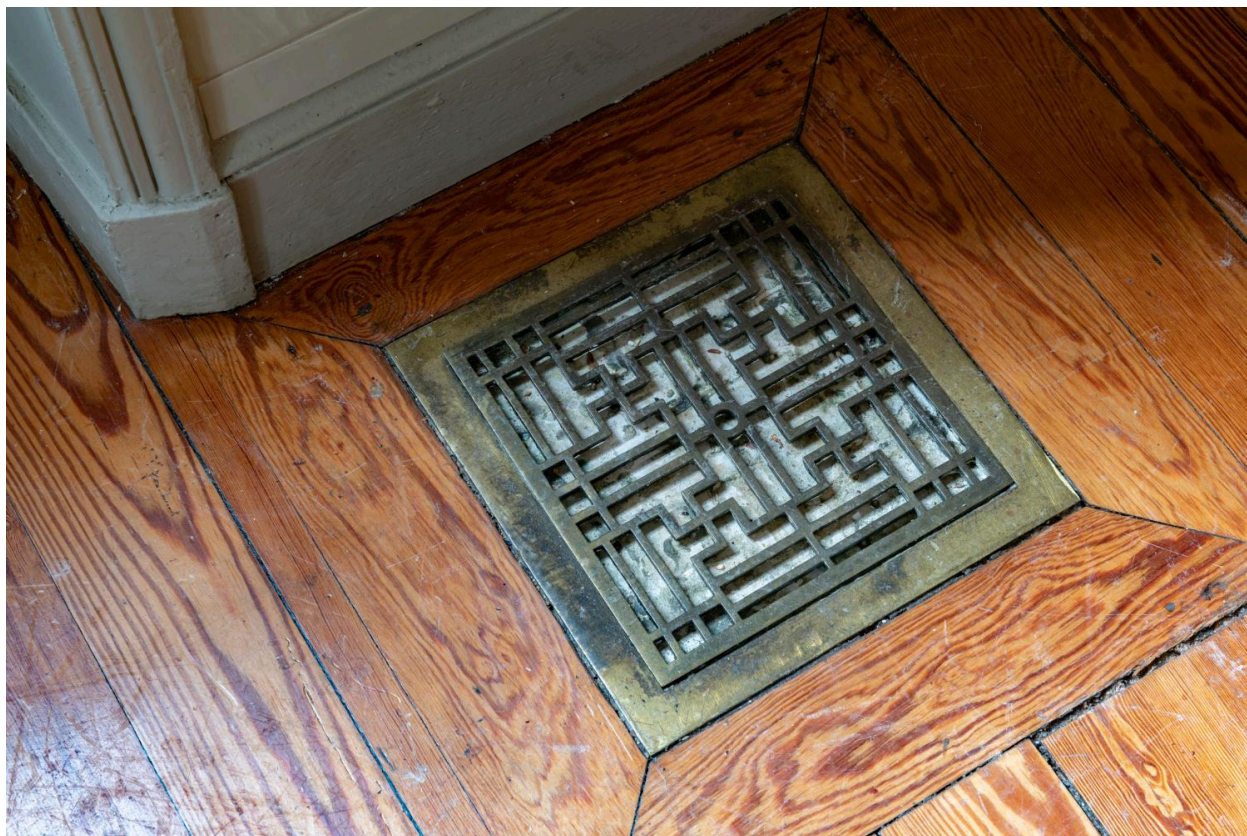
Grille de chauffage dans l'un des salons du rez-de-chaussée.
