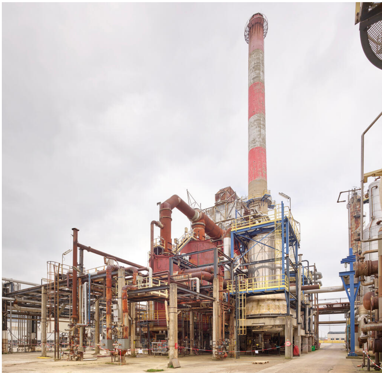
Unités Ouest - Reformeur catalytique (Unité 642).
