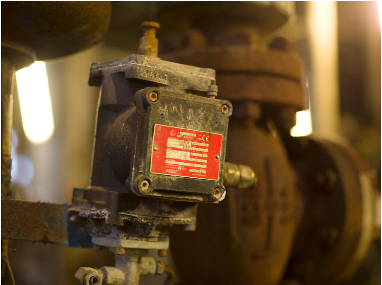
Unités Ouest - Zone de distillation (Unité 612). "S.O.V", système pneumatique d'ouverture ou de fermeture de vannes de sécurité.
