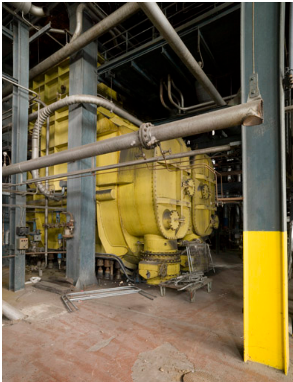
Condenseur de la tranche 125 MW.
