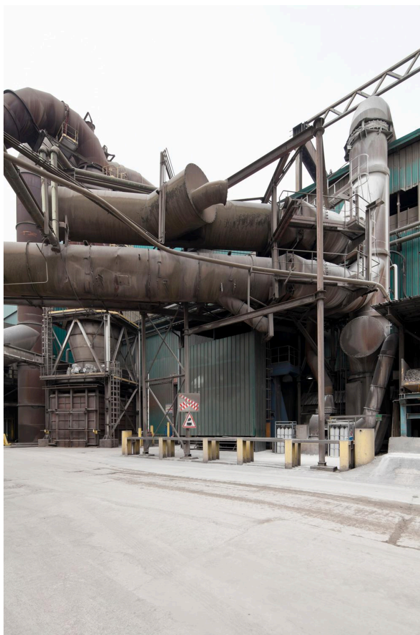
Système de dépoussiérage. (réf. Département de Seine-et-Marne : IVD77_2013_77_00266_NUCA)
