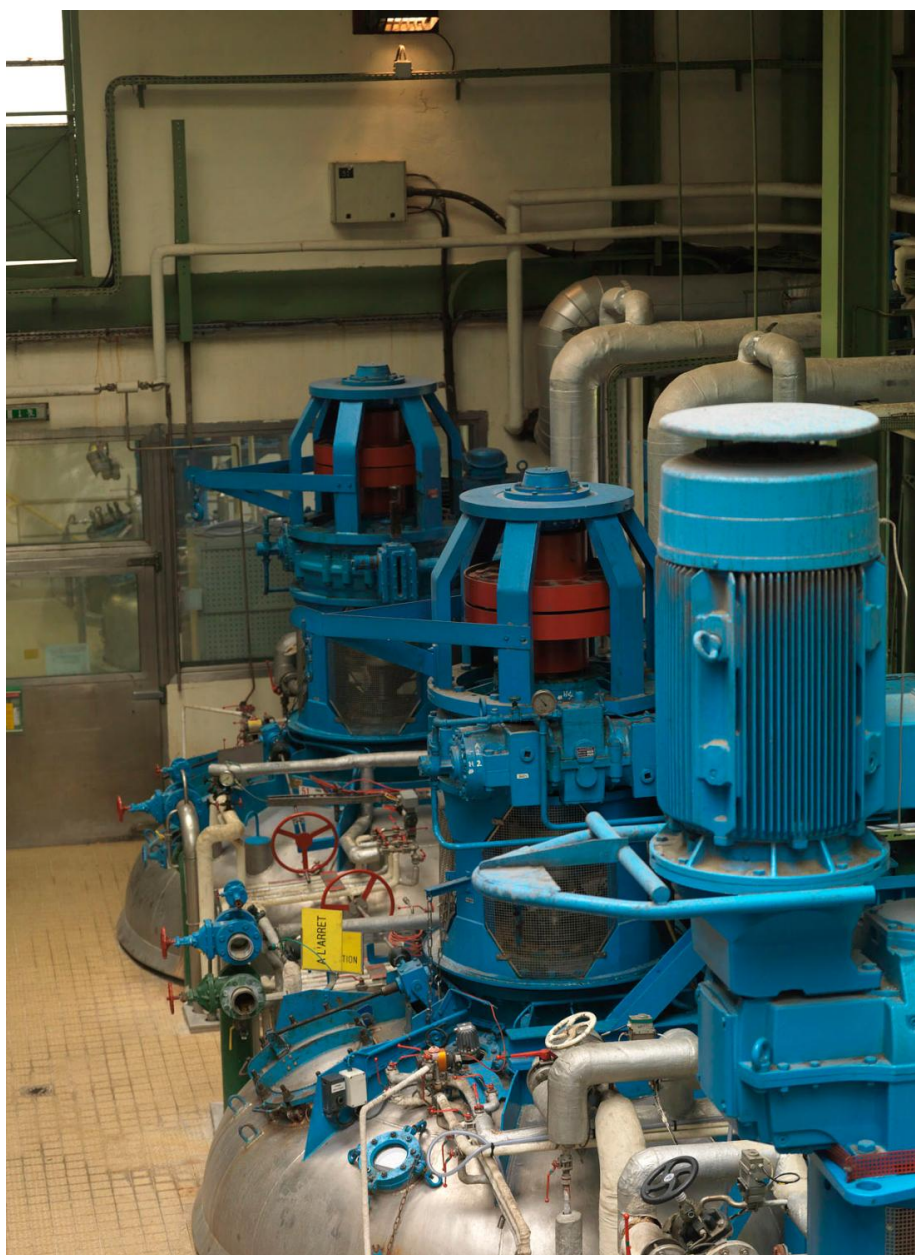
Site Sanofi. Bâtiment de transformation. Cuves.
