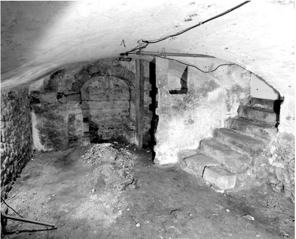
Premier niveau de cave au 5, rue du Château : à droite, l'escalier donnant sur le square Jacqueline-Cottard.
