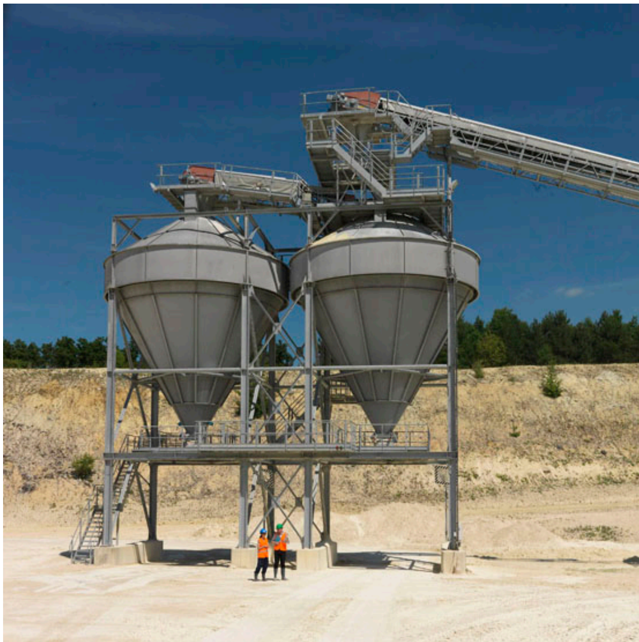
Plateforme - installation secondaire.
