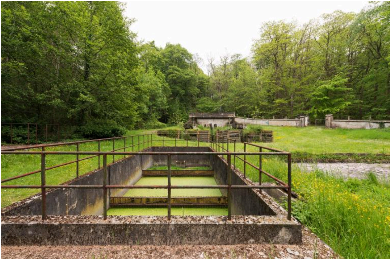
bassin d'épuration : au 1er plan : bac de décantation
