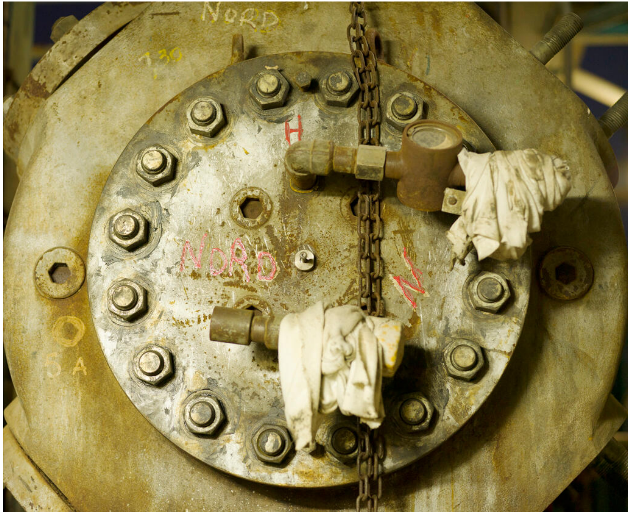
Unités Ouest - Reformeur catalytique (Unité 642). Compresseur 642 K60, vue du cylindre nord du compresseur.
