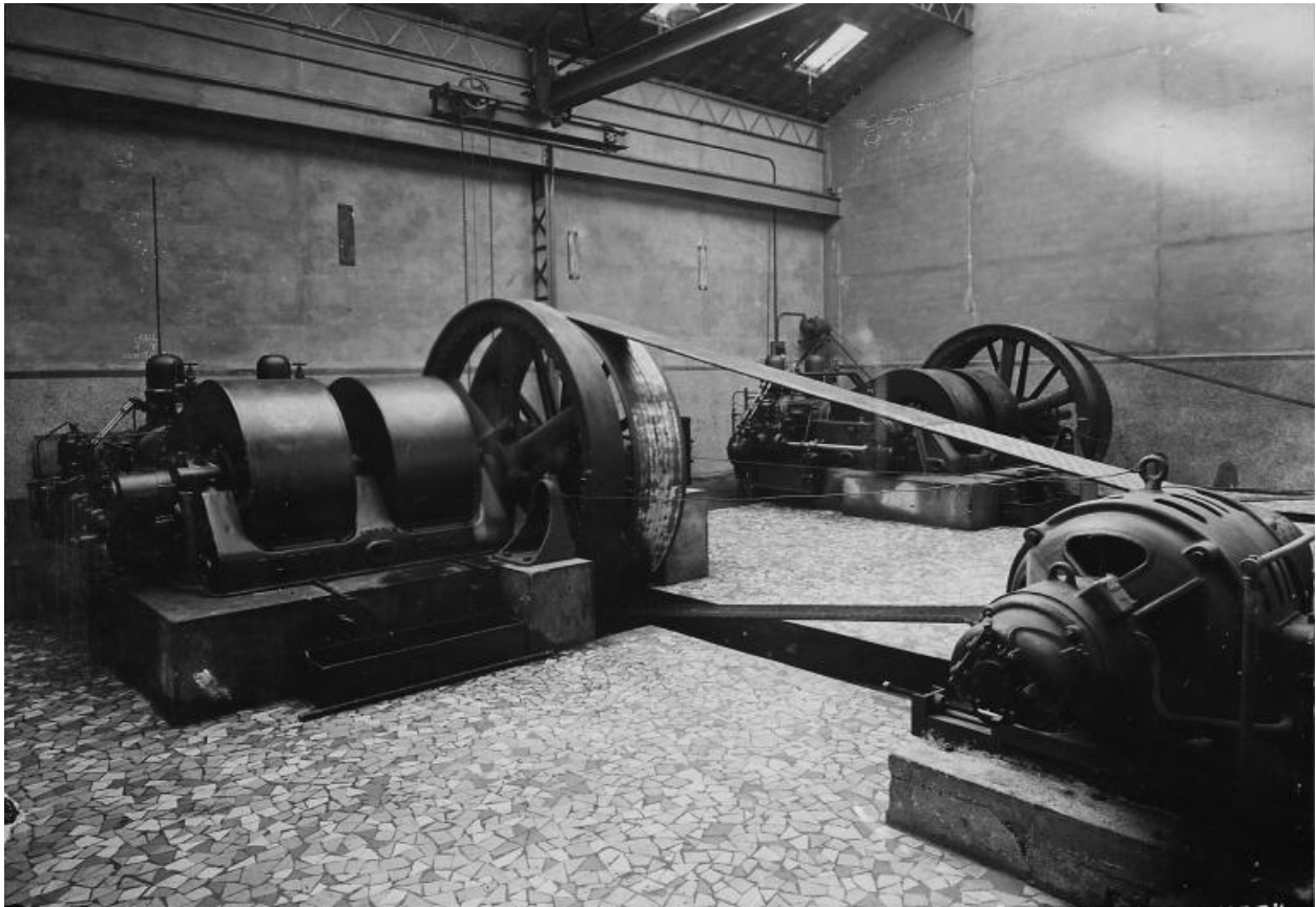
Moteur Ruston (fabriqué en Angleterre) de la salle des générateurs électriques, vers 1960. Photographie. (AD Seine-Saint-Denis. A NB 118)
