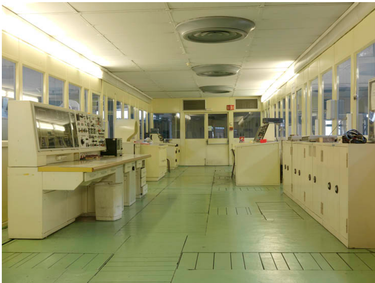
Plateforme d'essais. Entreprise Jeumont-Electric. Vue intérieure d'une salle de contrôle.
